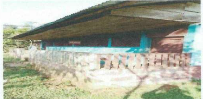
Foto 4: VISTA DE LA PESTAÑA DE MADERA YA PANDEADA POR EL SOL DEL CENTRO EDUCATIVO CON NECESIDADES DE REMOZAR.
