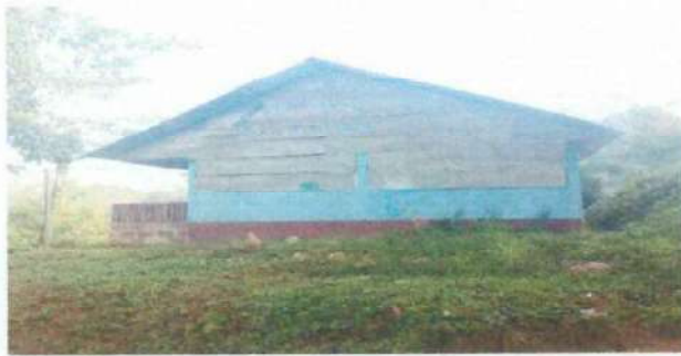
Foto 3: VISTA DEL LADO IZQUIERDO CENTRO EDUCATIVO CON LA NECESIDAD DE REMOZAR LA MADERA YA DETERIORADO A HILADAS DE BLOCK.
