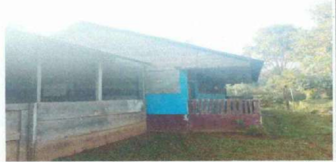
Foto 2: VISTA DE LA PARTE DERECHA DEL CORREDOR CENTRO EDUCATIVO PARA REMOZAR YA QUE SE ENCUENTRA DETERIORADO Y CON GRIETAS..
